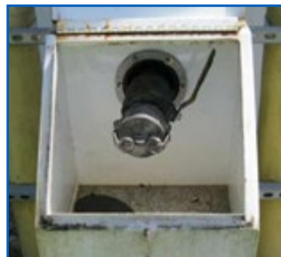
Fill Cap on Fill Pipes
